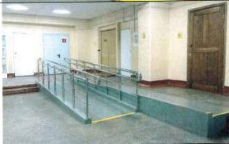
Лестничный подъемник, пандус (фото_6)
